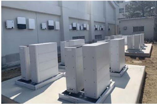
施設用自家消費電池システムの設置例
