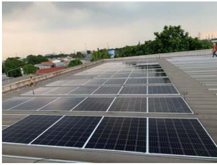
社屋屋上への設置例
